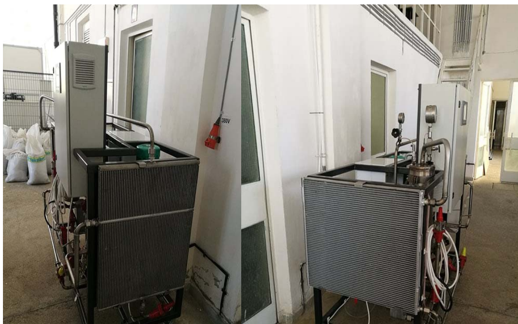
Fig.18 – Instalație frigorifică cu absorbție cu soluție NH 3 -H 2 O – prototip realizat – vedere laterala dreapta/stânga
