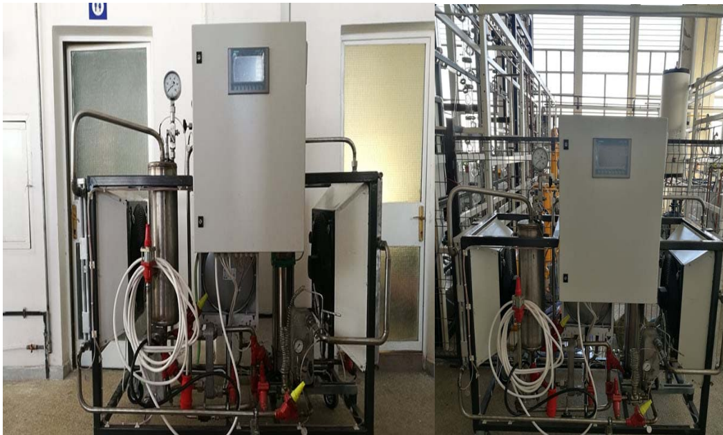
Fig.17 – Instalație frigorifică cu absorbție cu soluție NH 3 -H 2 O – vedere frontală
